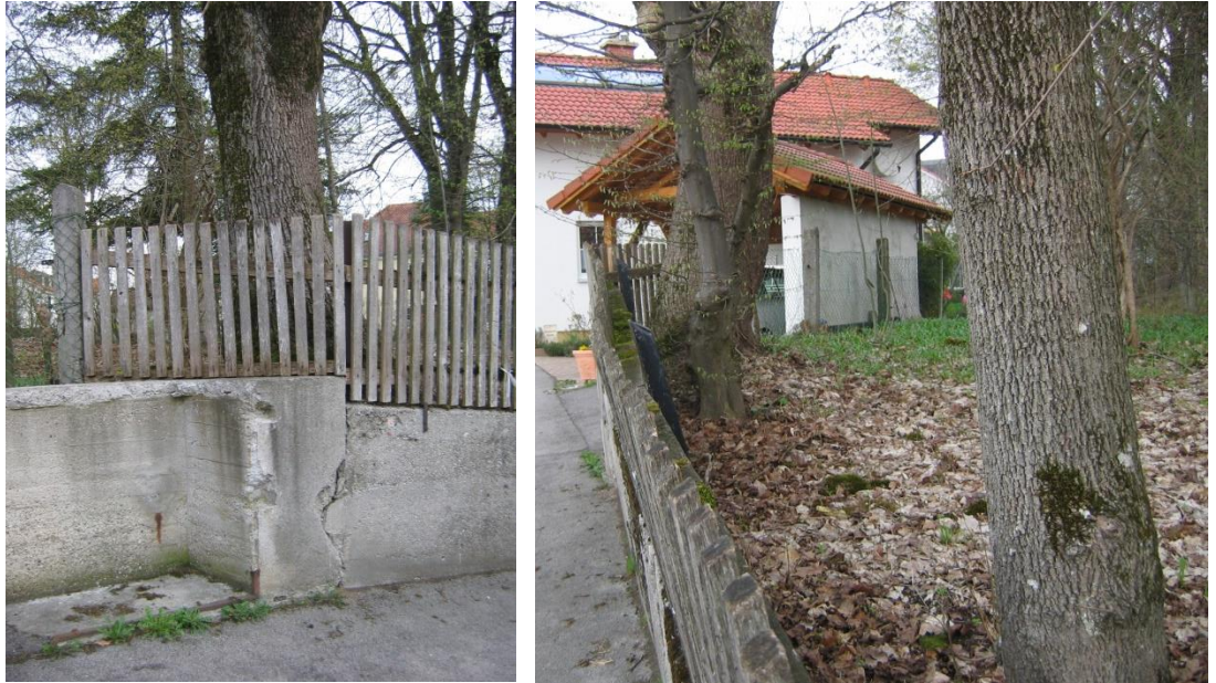
Abb. 4 Bauschäden an der Stützmauer und Baumbestand unmittelbar oberhalb (2013)
