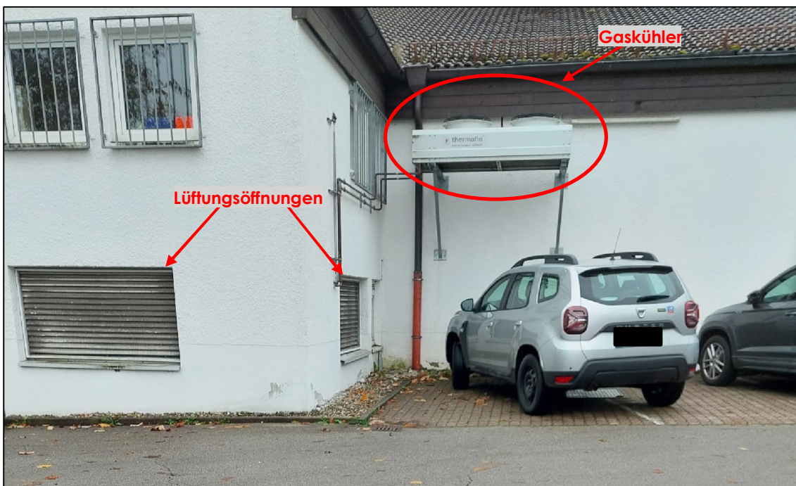
Abbildung 7: Anlagentechnik des bestehenden Netto-Marktes
