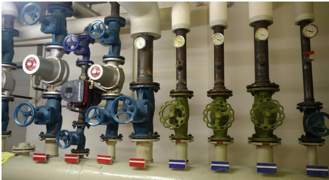
Abbildung 10-1: Veralterte Wärmeverteilung und Regelungstechnik
