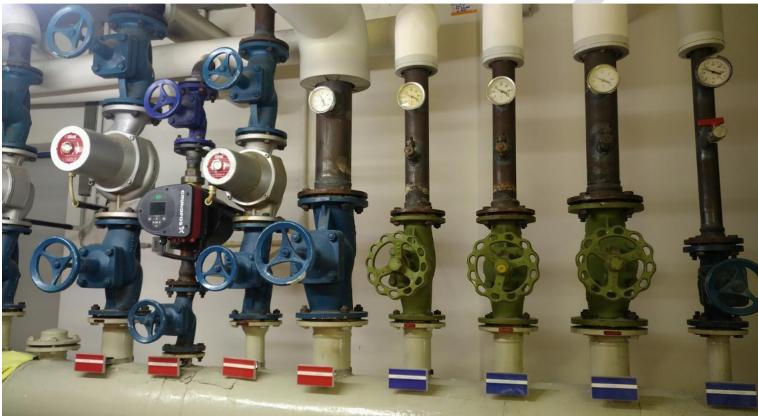
Abbildung 10-1: Veralterte Wärmeverteilung und Regelungstechnik
